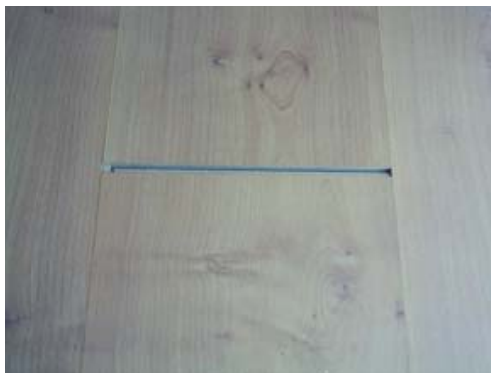
Separación de tablas producto del uso, sin la debida exceso de productos de limpieza y humedad.
