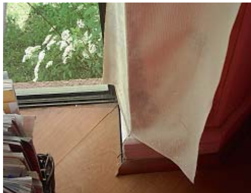
Daño mayor en papel mural producto de humedad, condensación y mal mantenimiento de la propiedad.
