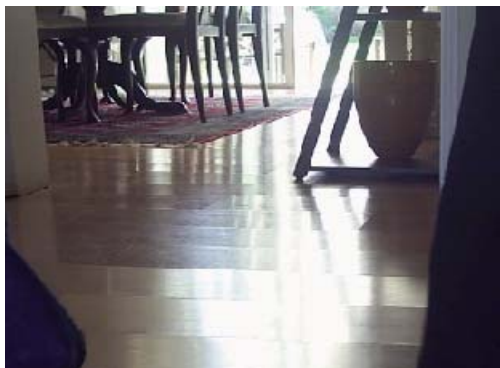
Piso fotolaminado levantado en las uniones producto de precaución y mantención.
