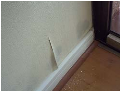
Papel despegado y con hongos producto de condensación y mala ventilación.
