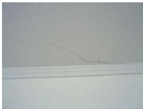
Fisura en cielos (No presenta peligro para los habitantes)
