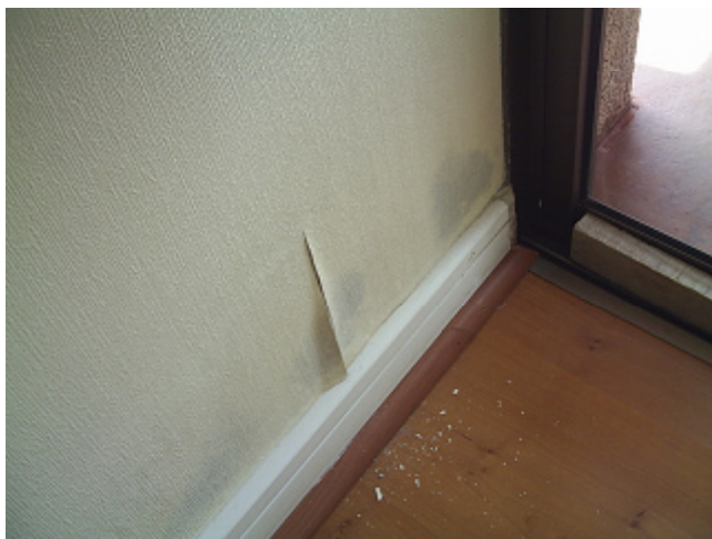
6 . Papel despegado y con hongos producto de condensación y mala ventilación.
