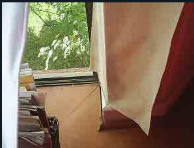
7: Daño mayor en papel mural producto de humedad, condensación y mal mantenimiento de la propiedad.
