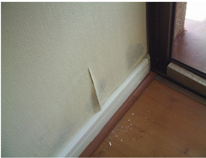
6 . Papel despegado y con hongos producto de condensación y mala ventilación.
