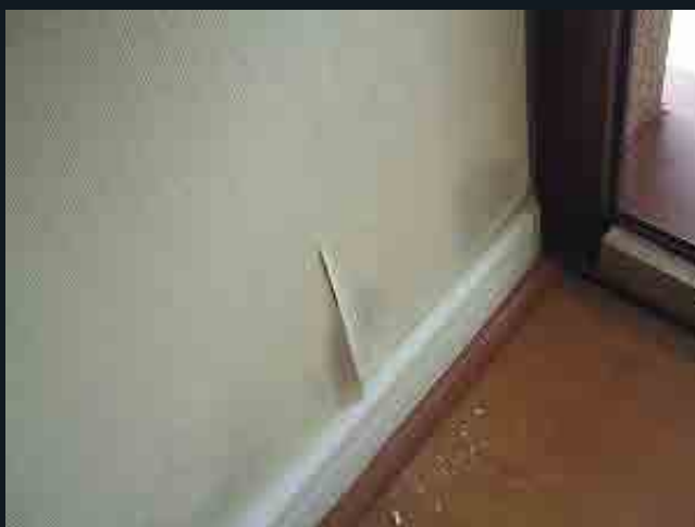
6 . Papel despegado y con hongos producto de condensación, humedad y mala ventilación.
