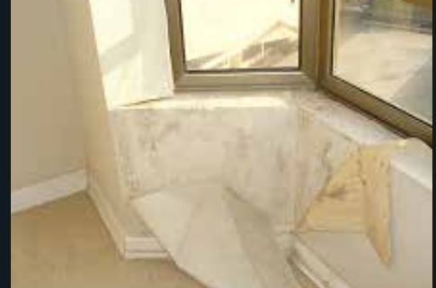
2. Papel mural con hongos debido a condensación y mala ventilación
