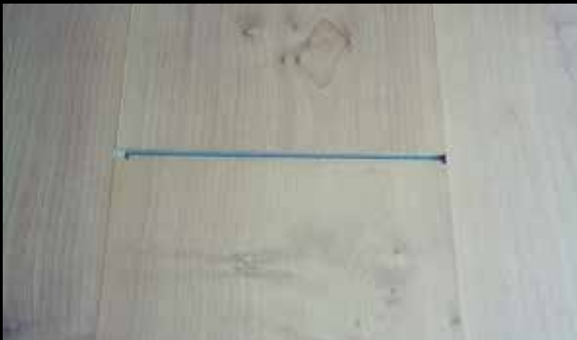
3. Separación de tablas producto del uso, sin la debida precaución y sin la debida precaución y mantención.
