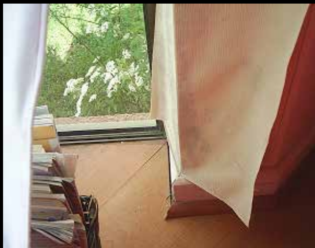
6. Daño mayor en papel mural producto de humedad, condensación y mal mantenimiento de la propiedad.
