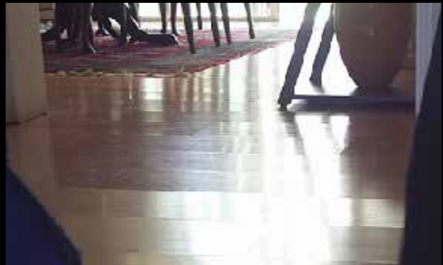
4. Piso fotolaminado levantado en las uniones producto del exceso de productos de limpieza y humedad.
