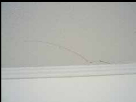
2. Fisura en cielos (No presenta peligro para los habitantes)
