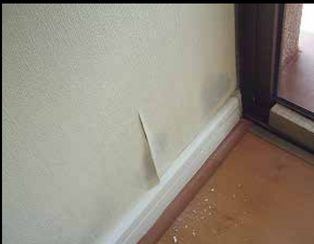
5. Papel despegado y con hongos producto de condensación, humedad y mala ventilación.
