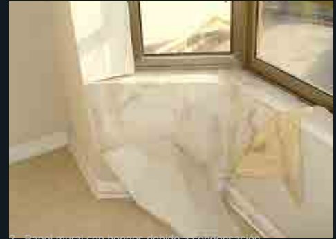
2. Papel mural con hongos debido a condensación y mala ventilación
