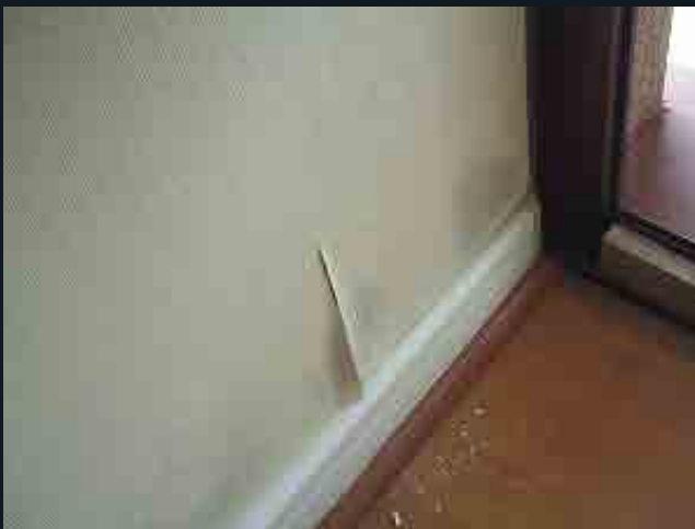
6 . Papel despegado y con hongos producto de condensación, humedad y mala ventilación.
